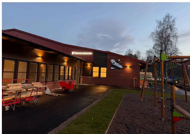
Bild från renoveringen av Peterslundsskolan. Här syns bytet till sadeltak samt nytt konstverk och ny ljusskylt.
